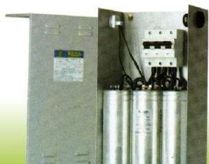
Capacitores trifásicos con protección termomagnética instalación de intemperie
